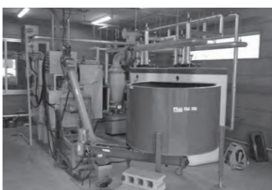
▲竹チップボイラー
