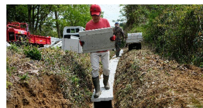
井路の蓋掛け (富士緒井路：軸丸地区)
